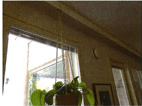
Kolmion olohuoneen korvausilmaventtiili auki
