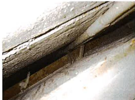
Kartoituksessa havaittiin ilmavirtausta hissikuilun viereisen sähkönousun sisällä porraskäytävien välillä
