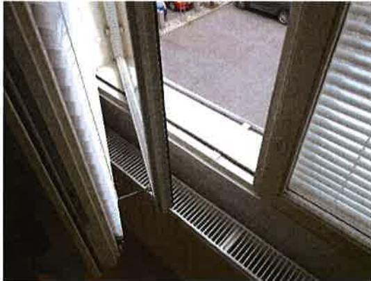
Makuuhuoneen ikkunaa ei saa lukittua ja ikkuna liikkuu tuulenpuskien mukaan
