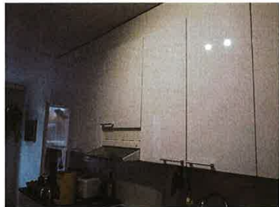
Kolmion keittiö ja liesituulettimen sijainti, tekniikkakanaali sijaitsee tiskipöydän takana
