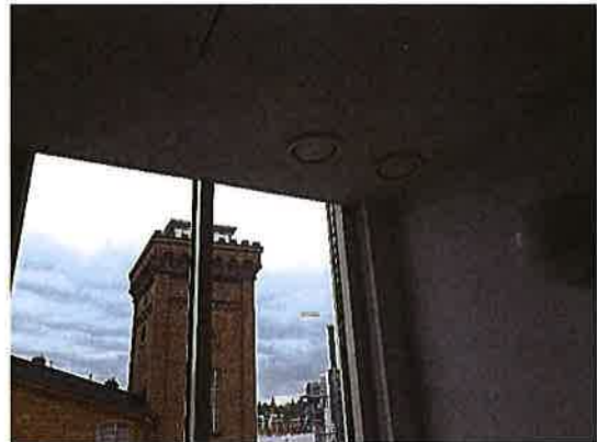
Porrashuoneen poistoilmaventtiilit (2 kpl) 8. kerroksessa
