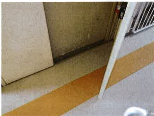
Porrashuoneen hissikuilun ovet eivät ole tiiviit porrashuoneen suuntaan
