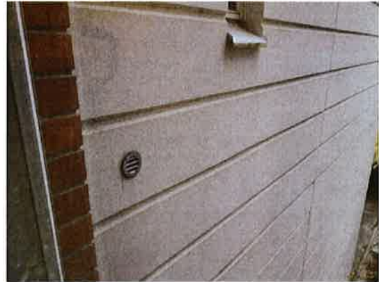
Kaksiodien saunan korvausilmaventtiili. Sijainnin puolesta hankala puhdistaa
