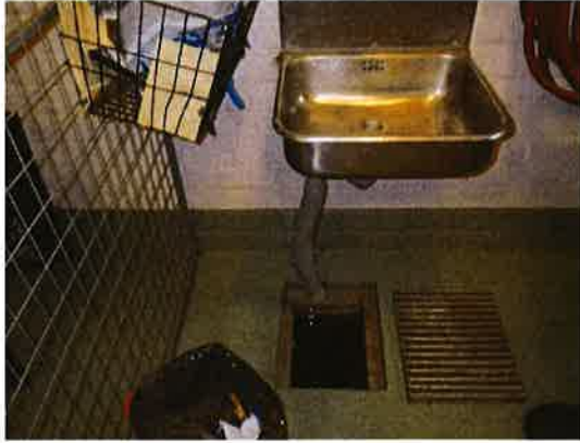
Siivoustilan kaatoaltaan lattiakaivosta aiheutuu tilaan voimakas viemärin haju, samassa tilassa irtainvarasto
