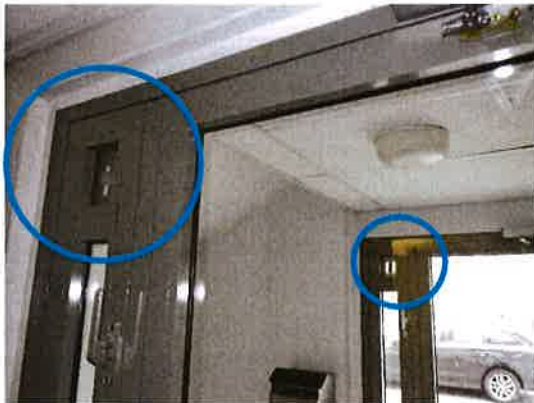
Porrashuoneen korvausilmaventtiilit ulko-ovessa ja tuulikaapin ovesa
