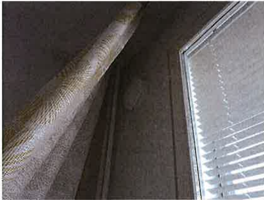
Kaksion olohuoneen korvausilmaventtiili kiinni
